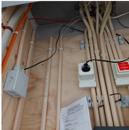
Voorbeeld meterkast met originele situatie
